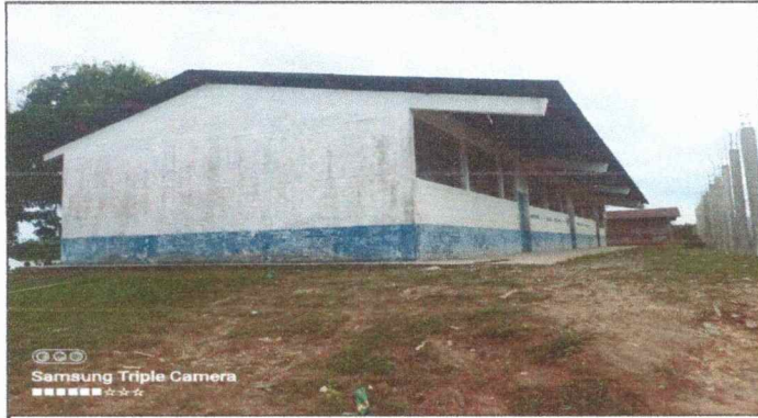
Foto1: Se necesita cambio de láminas del techo del establecimiento porque se encuentran muy deterioradas debido a que ya tienen 20 años en uso.
