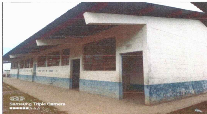
Foto 3: Se necesita cambio de 5 puertas de metal, debido a que llevan 20 años en uso y ya se deterioraron.
